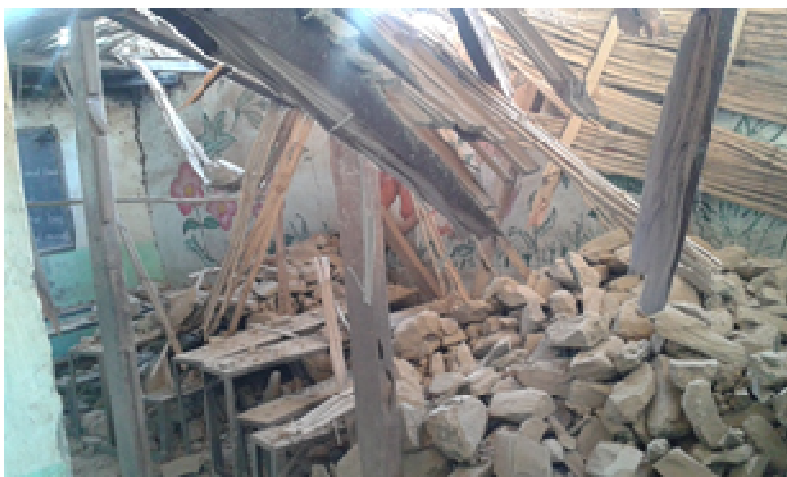
Eines der durch das Erdbeben zerstörten Klassenzimmer
